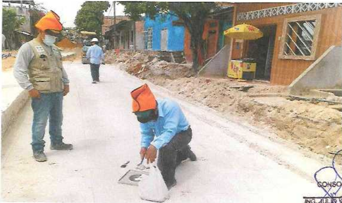
FOTOGRAFÍA 03: PRUEBA DE DENSIDAD DE CAMPO DE CAPA ANTICONTAMINANTE CON MATERIAL (A-3) A NIVEL DE SUB BASE EN LA CA. URARINAS.
